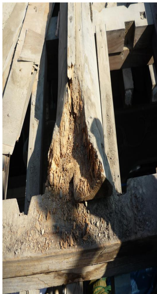
本堂の軒下 腐食状況
