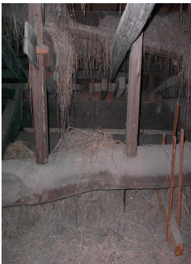
「本堂屋根小屋に大量なワラ」
