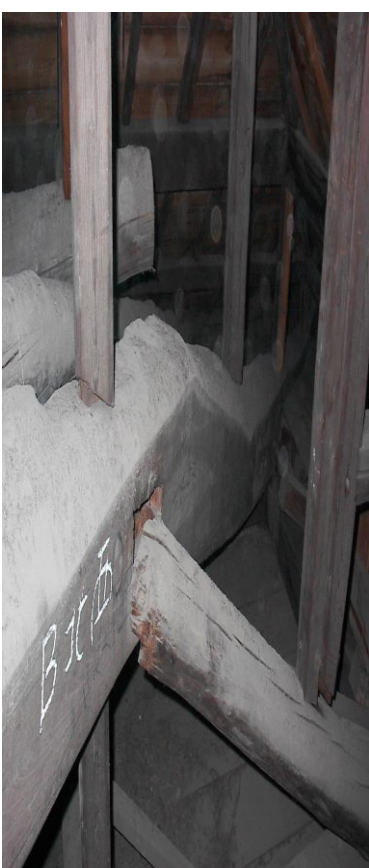
屋根小屋内 「繋ぎ目が外れている」
