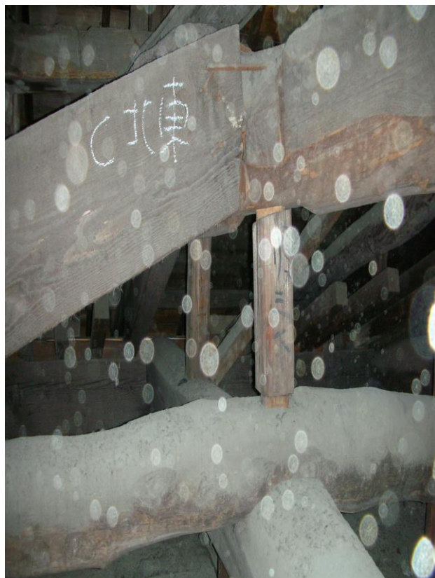
「屋根小屋梁の柄が浮いている」
