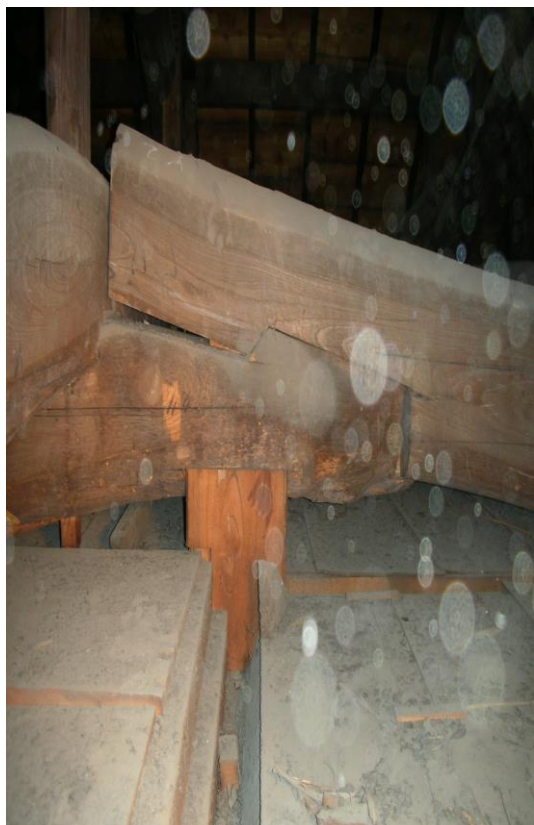
「屋根小屋内 つなぎ目の所が浮いている」
