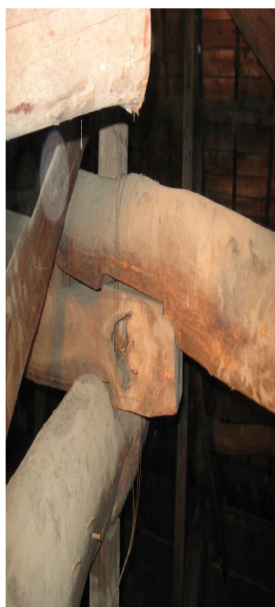
屋根小屋内 「繋ぐ目が不良」
