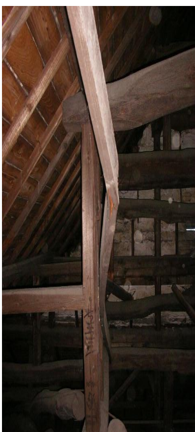
屋根小屋内 「筋交いが折れている」
