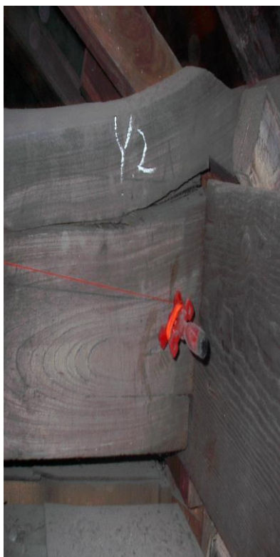
屋根小屋内 「裂けている所がある」
