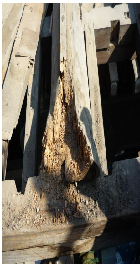
「向拝の軒先腐り状況」
