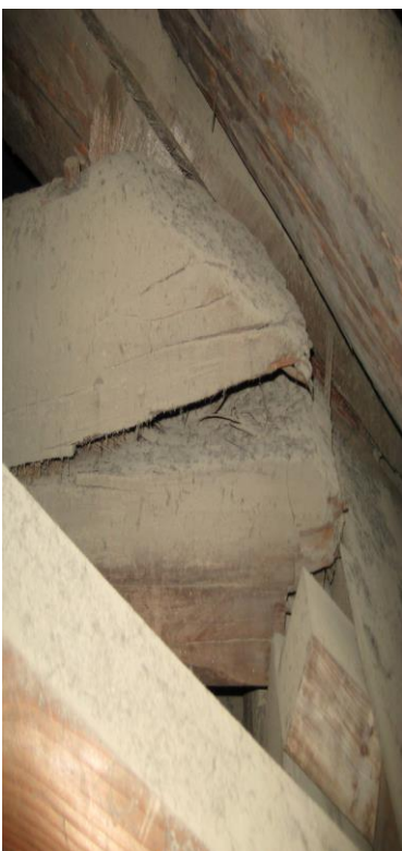
屋根小屋内 「つなぎ目が良くない。裂けている」
