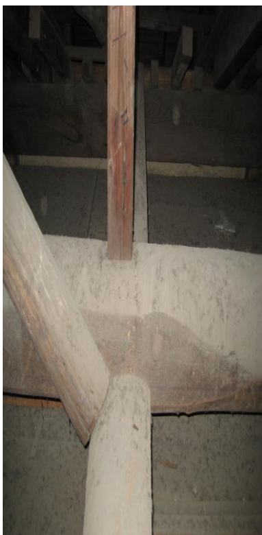
屋根小屋内 「柱が細い」「中心よりずれている」
